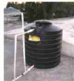
Réservoir d'eau figure (16)
